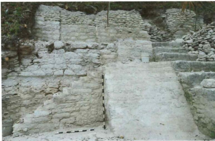
Restauración de edificio B-17, área de talud, gradas de acceso laterales, muro oeste inferior y muro oeste superior alero norte. Fotografía Livni Almira, 2021.
